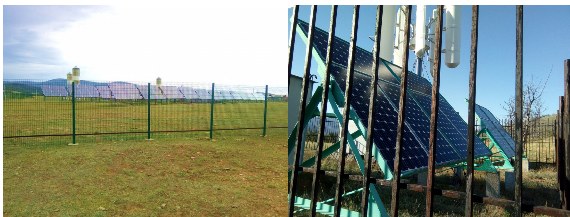
Электростанция на солнечных батареях в Онгурёне (снимок слева). Антенна Теле2 (справа)
