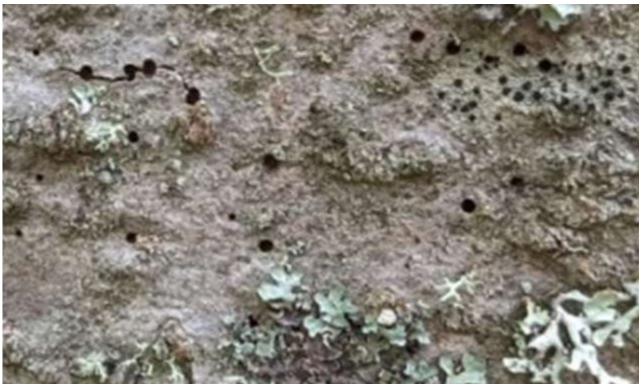
Рисунок 3 – Входные отверстия жуков. Большемуртинский район Красноярского края
