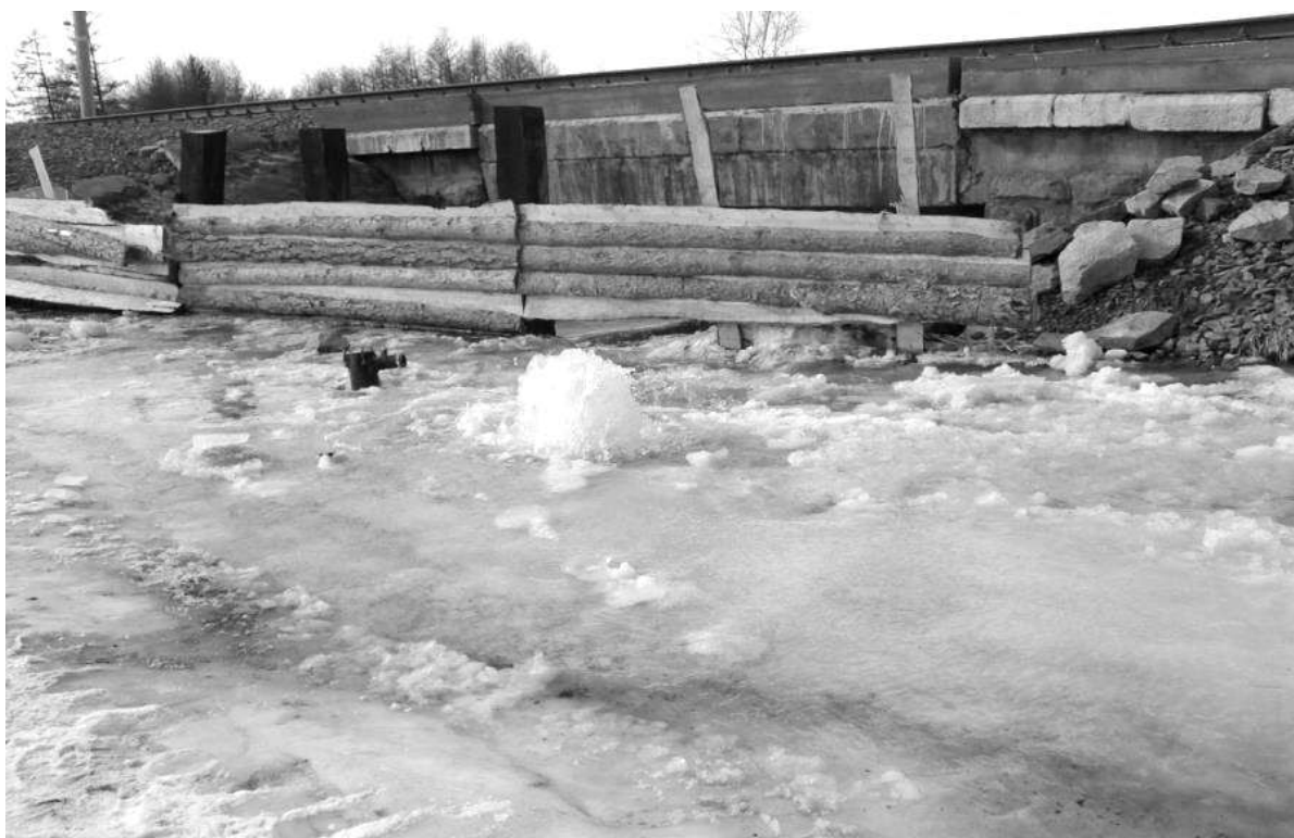
Рисунок 2 – Выход напорных вод из скважины № 6 перед щитом у моста
