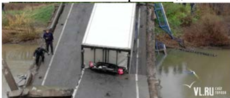
Рис.2. Мост через реку Кипарисовка в Приморском крае, не ремонтировавшийся свыше 20 лет
