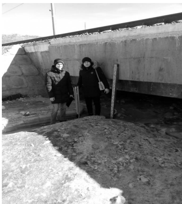
Рис. 2. Обследование образования наледи под мостом
