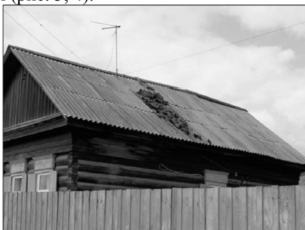
Рис. 3. Массовое падение печных труб в пос. Култук при землетрясении 2008 г
