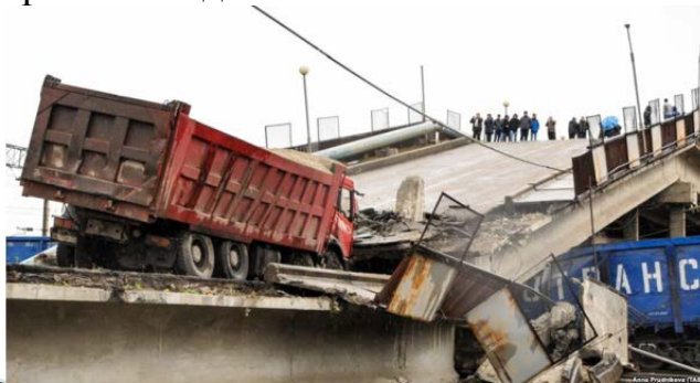
Рис.1. Разрушенный автомобильный мост в городе Свободном Амурской области в октябре 2018 года
