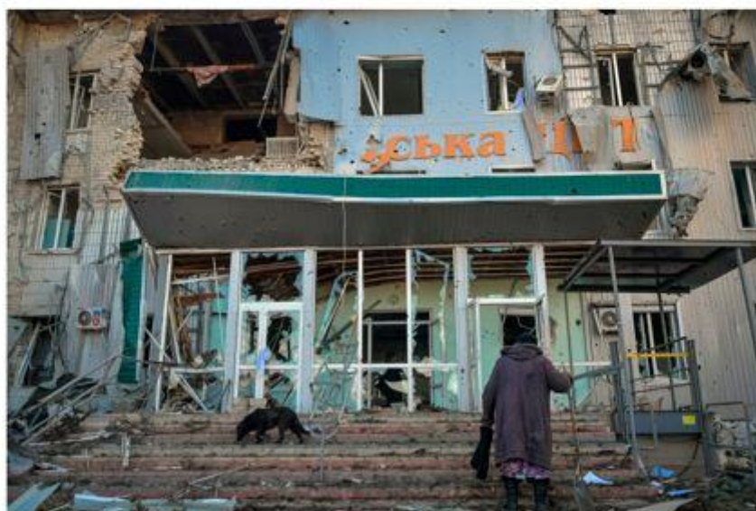
Женщина у здания городской больницы, разрушенного в результате обстрела в Волновахе, 12.03.2022 Фото: Алексей Куденко, РИА Новости
