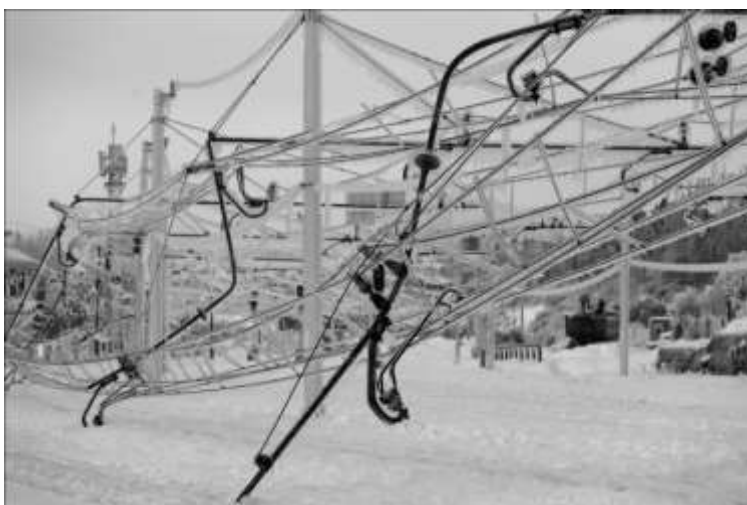
Рис. 2. Гололёдные явления на контактной электросети
