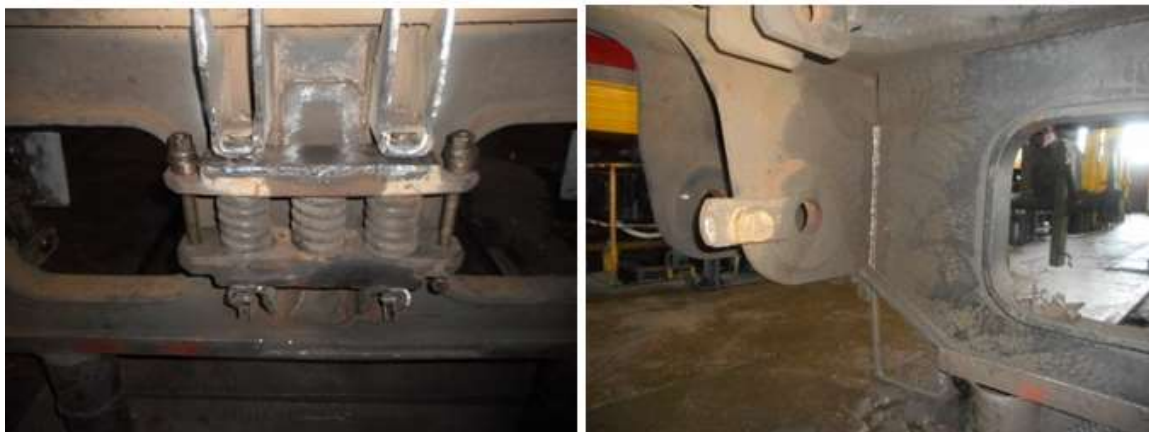
Рис. 3. Усиление сварных швов рамы тележки
