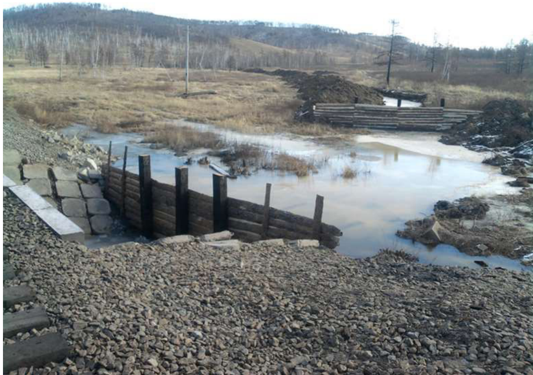
Рис. 2. Установка заборов на пути образования наледи перед искусственным сооружением
