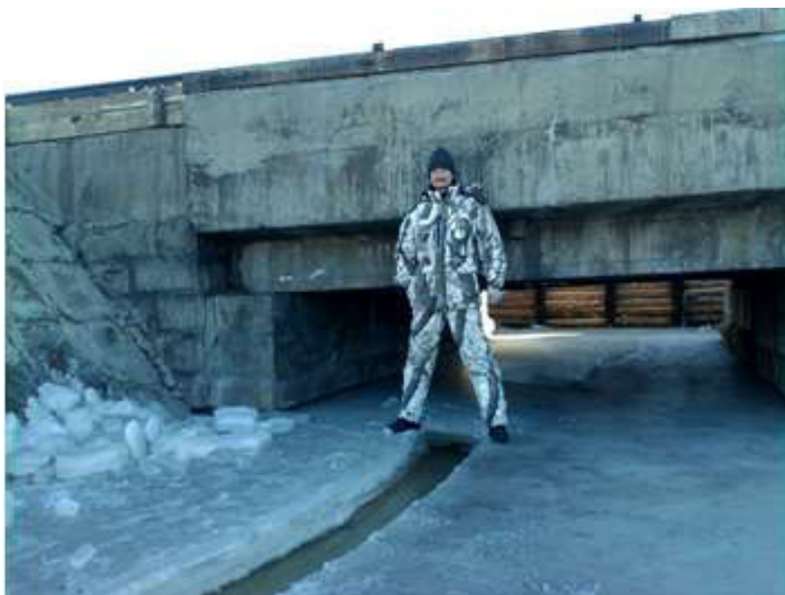
Рис. 1. Образование наледи под железнодорожным мостом
