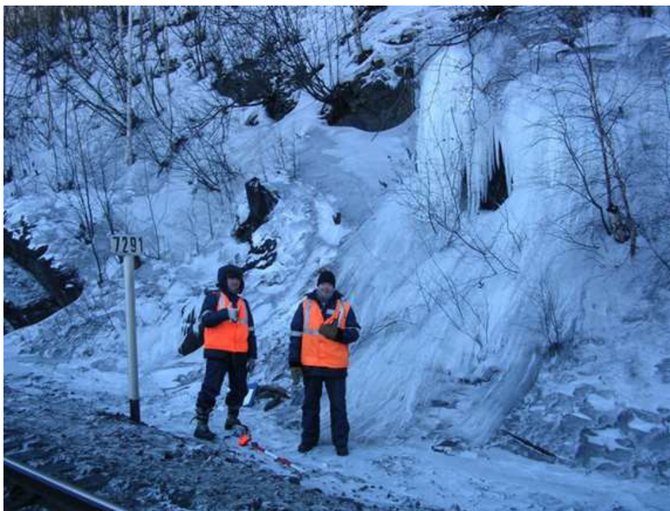
Рис. 1. Сотрудники Забайкальского института железнодорожного транспорта у наледи подземных вод на склоне выемки
