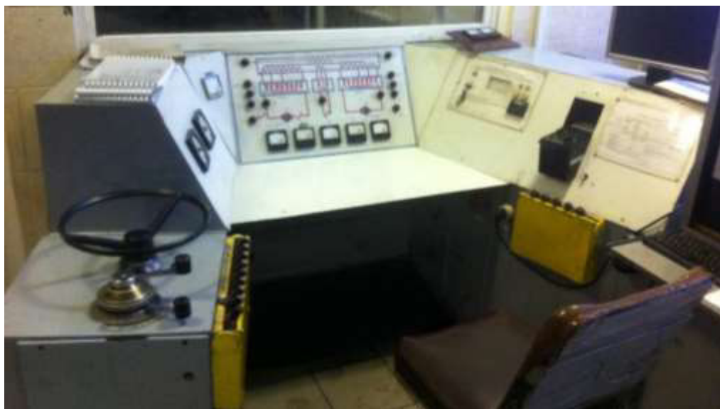
Рис. 4. Пульт управления испытательной станцией СЛД «Боготол-Сибирский» Красноярской железной дороги
