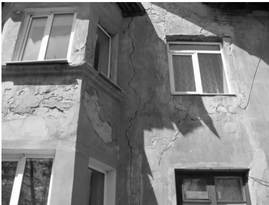
Рис. 3. Примеры повреждений зданий
